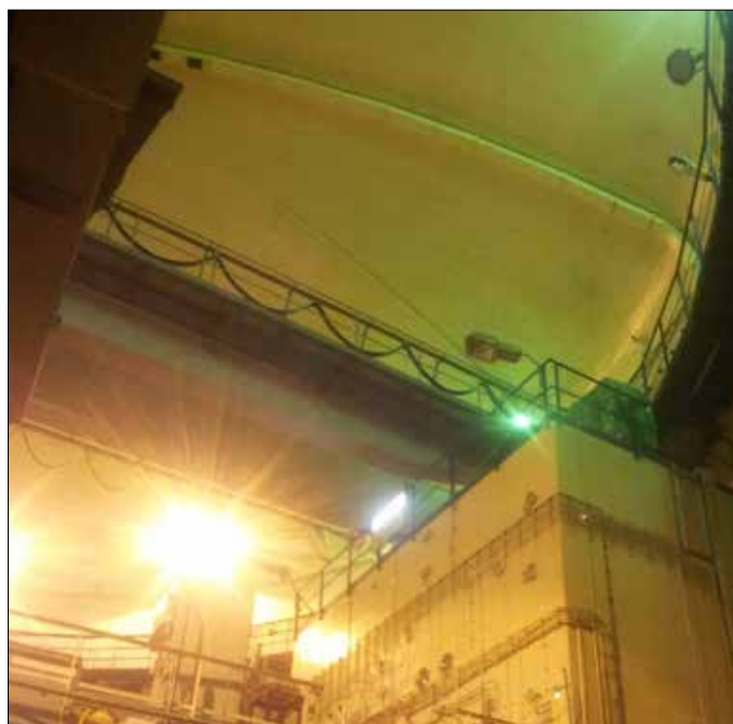
Na hali. Oslona antyradiacyjna.
